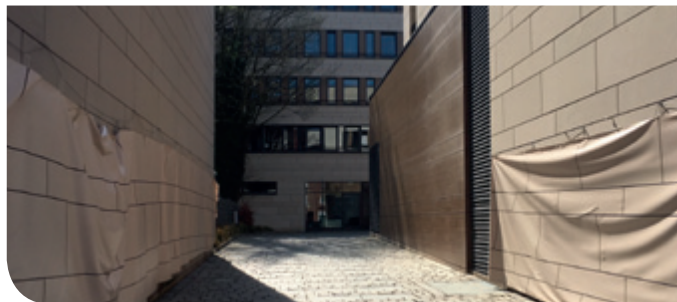
Unzählige wertvolle Sandsteinplatten wurden mittlerweile an den neuen Verwaltungsgebäuden zerstört. Plastikplanen verdecken provisorisch die Schäden.
